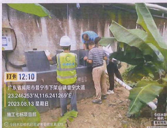
施工七标项目部生活污水
