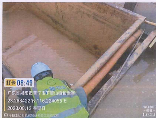
PN17 顶管井生产废水
